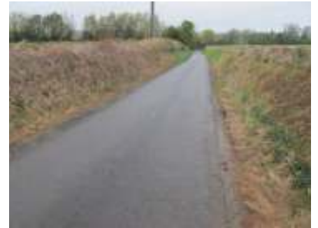
Illustration 12 : dégâts infligés aux talus ...
